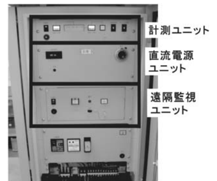
写真-1 遠隔監視機能付き 直流電源装置
